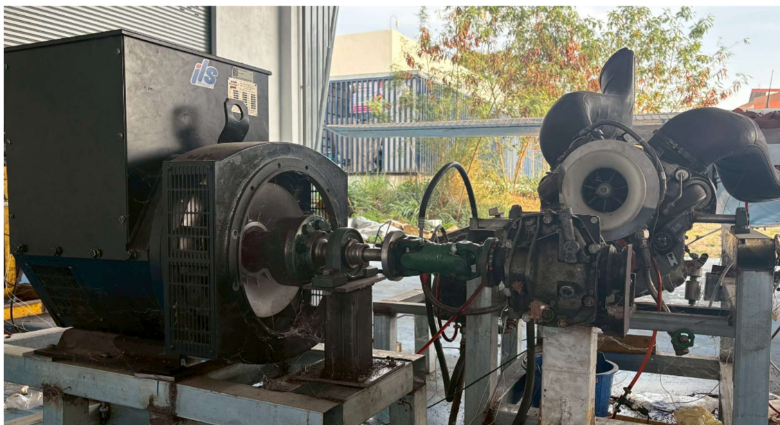
รูปที่ 4.14 เครื่องกำเนิดไฟฟ้าที่ต่อเข้ากับเครื่องยนต์ Gas Turbine ผ่านชุดส่งกำลัง
