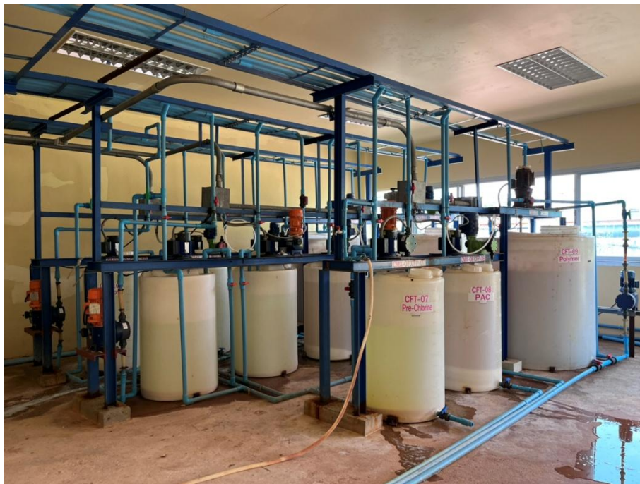
รูปที่ 2 ป้มนส่งจ่ายสารเคมี
