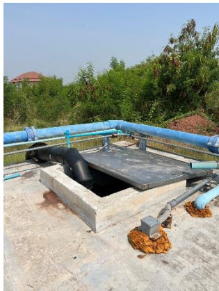
รูปที่ 8 ถังตกตะกอนชั้นที่ 2 ของระบบผลิตน้ำประปาชุดที่ 5
