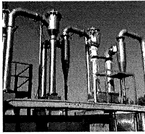
ระบบทำความสะอาดแก๊สเชื้อเพลิง (สกรับเบอร์)
